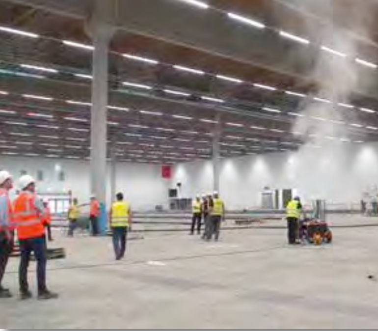
Heißgasrauchversuch zur Abnahme in der Ausstellungshalle 12.10.
