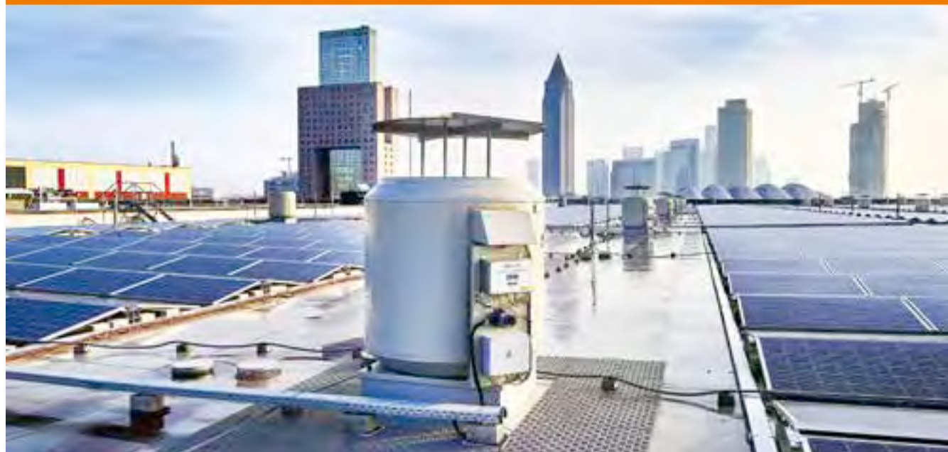
Auf dem Dach der Messehalle 12: Die TROX X-FANS Dachentrauchungsventilatoren BVD sind mit dem intelligenten VentilatorDiagnosesystem ausgestattet.
