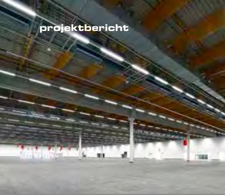
Energieeffizient: Induktionsdurchlässe des Luft-Wasser-Systems.
