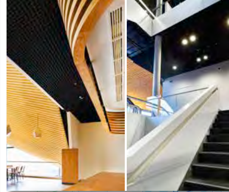
Rauchdruckanlagen im Treppenraum sichern eine rauchfreie Entfluchtung.
